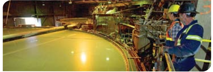
Dan Duivenvoorden, superviseur des dispositifs de traitement des eaux chez la Denison Environmental Services (DES), et Kaori Torigai, gestionnaire de projet de l'équipe de gestion du projet de la mine Faro (EGPF), examinent le réservoir de clarification qui fait partie du dispositif de traitement des eaux Faro.
